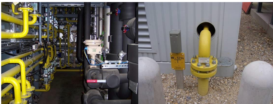
Figura 14.8. Secția de purificare a biometanului prin metoda PSA (stânga) și conexiunea la rețeaua de gaz natural (dreapta) ale Uzinei de biometan din Pliening, Germania (RUTZ, 2007)
